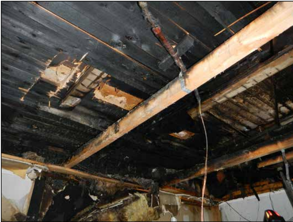
Bild tagen på takkonstruktionen i startutrymmet efter att innertaket har rivits ner.
