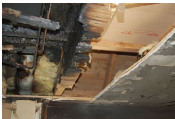
Här ser man nyttan med gips i taket. Inledningsvis har man lokaliserat branden i bjälklaget med hjälp av en värmekamera och därefter skjutit genom innertaket med skärsläckaren. Därefter har styrkan haft god tid på sig att plocka ner innertaket.
