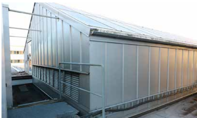
Friskluftsintag på taket.
