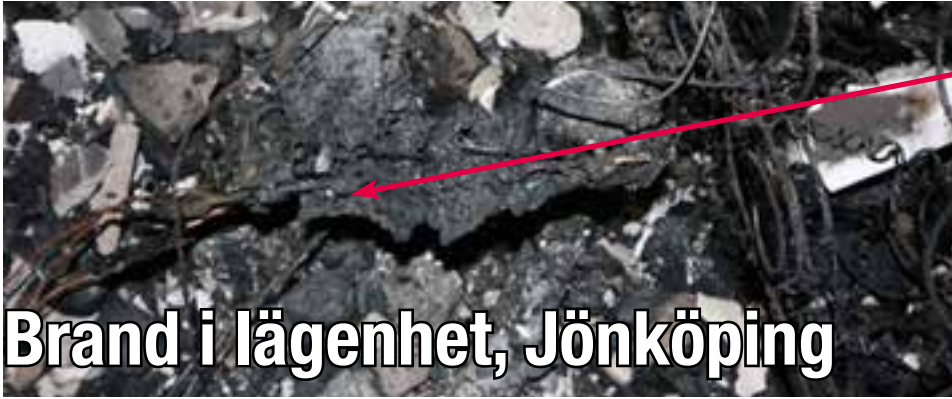
Den brandskadade grenkontakten.
